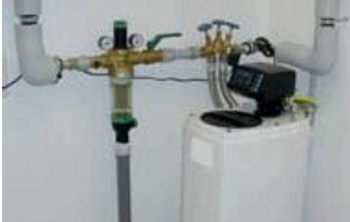
Beispiel einer Wasserenthärtungsanlage (Ionentausch-Verfahren)
